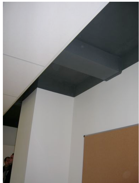
Dans les classes, le double plafond laisse apparaître les systèmes de ventilation
